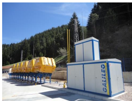
Външно газохранилище и АГРС - Чепеларе
